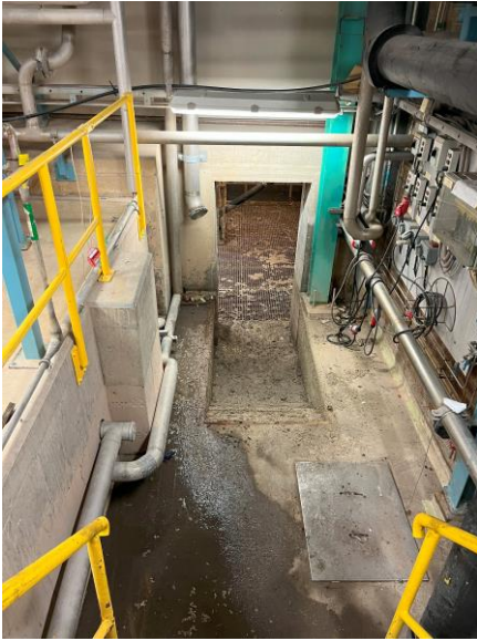
Figur 4. Pumpgrop i huvudbyggnaden. Härifrån pumpas vattnet vidare till rening eller slaggvattentankar.
